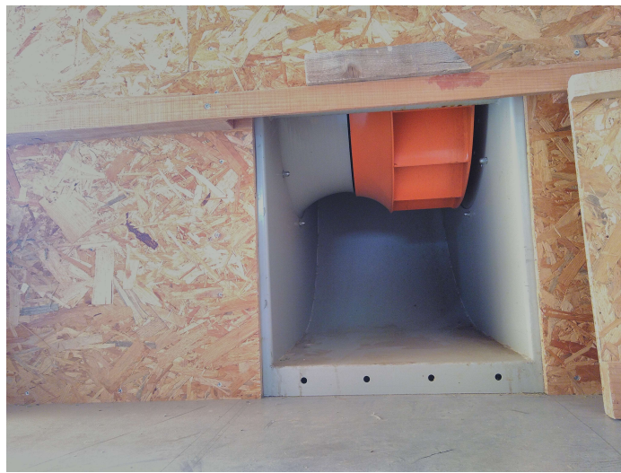
Illustration 4: Sortie de gaine - vue sur le ventilateur centrifuge
