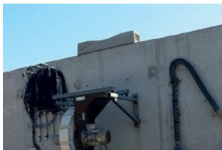
Ventilation du compost
