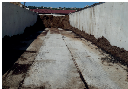
Silo de compostage aéré et récupération des jus
